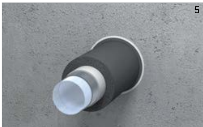
Ggf. Kontrolle der Abschottung.
