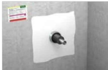
Nicht brennb. Rohr mit brennb. Dämmung.
